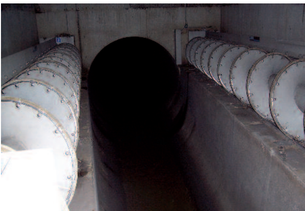
Tamices aliviadero HUBER ROTAMAT® RoK 1 instalados a 60º de inclinación a ambos lados del aliviadero.
