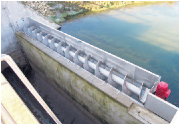
Tamiz HUBER ROTAMAT® RoK 1 instalado en el labio del vertedero.
