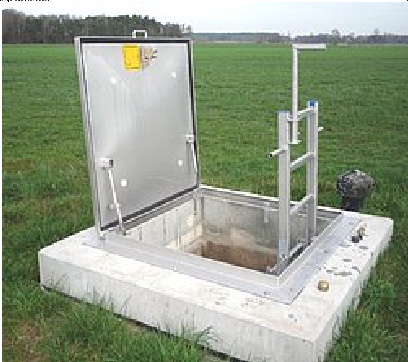
Equipamiento seguro: Tapas de registro, escaleras de seguridad y dispositivos de ascenso
