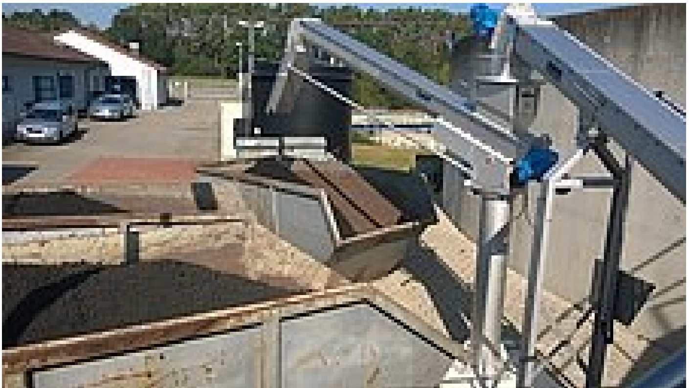
HUBER Tornillos transportadores Ro8 T para lodo desecado en la central de energía de Hausen. Sistema de carga del libre rotación con lanzadera ajustable para una alimentación del contenedor simple y variable
